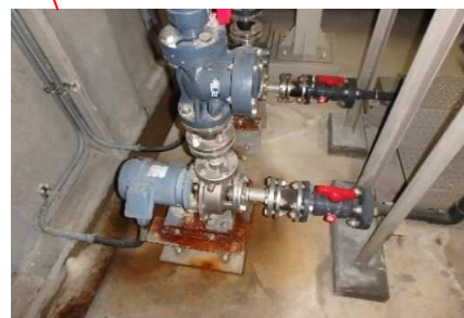
粒状活性炭吸着槽 （サンプリングポンプ）
