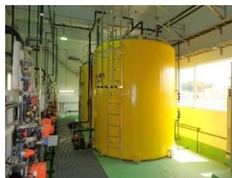
次亜貯蔵槽（2期工事）
