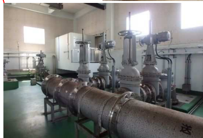
中間ポンプ棟内 電動仕切弁
