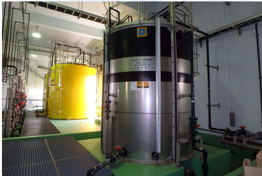
既設苛性ソーダ貯蔵タンク（更新）
