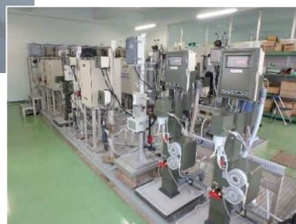
中間ポンプ棟（水質計器）
