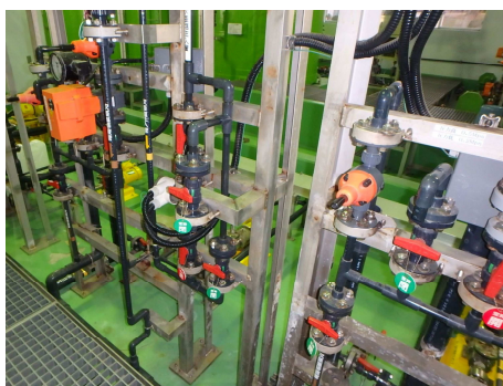
次亜注入ポンプ（2期工事）
