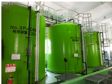
PAC貯蔵槽（1期工事）
