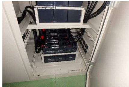
自家発電機室（蓄電池）
