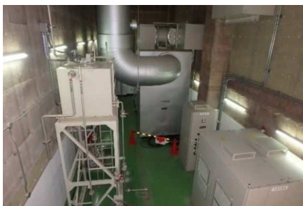
自家発電機室
