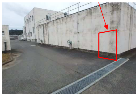
現場操作盤設置箇所
