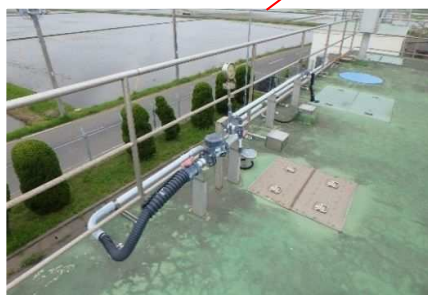
粉末活性炭接触池 （サンプリングポンプ）
